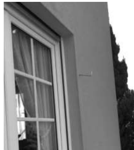
Der Hering, der aus dem umgewehten Zelt direkt in die Nachbarsfassade flog und dort stecken blieb.
